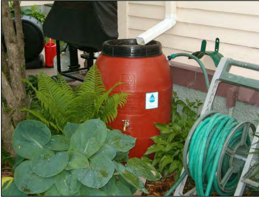
Figur 16. Regnvattentunna för magasinering av dagvatten
