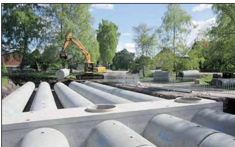
Figur 22. Exempel på utjämningsmagasin bestående av rörpaket i betong (Alfarör)
