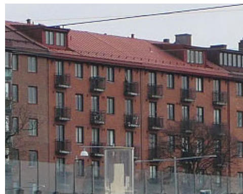
Gatufasad från håll, taklandskapet har en hög exponeringsgrad. Takkuporna tillkom på 1980-talet.
