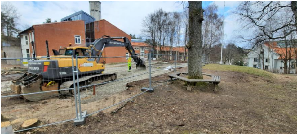
Figur 2. Västra delen av området. Bild tagen mot öster. Pågående arbeten i tänkt läge för utbyggnad av huvudbyggnad (Alternativ A). Berg i dagen lokalt där fotografen står.
