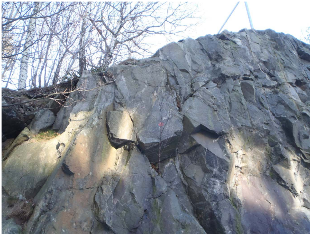
Foto 7. Det förekommer potentiellt instabila block i den norra skärningen (område 2), vilka vid en tidigare inspektion markerats för bultning (röd sprutfärg).
