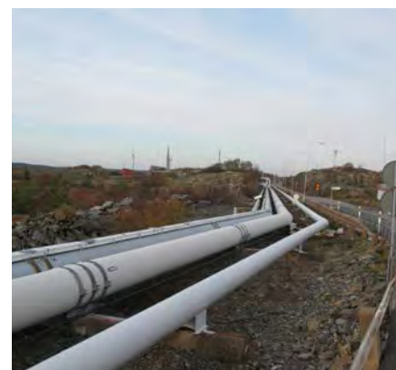
Ett läckage på oljeledningarna kan ge allvarliga konsekvenser för miljön
