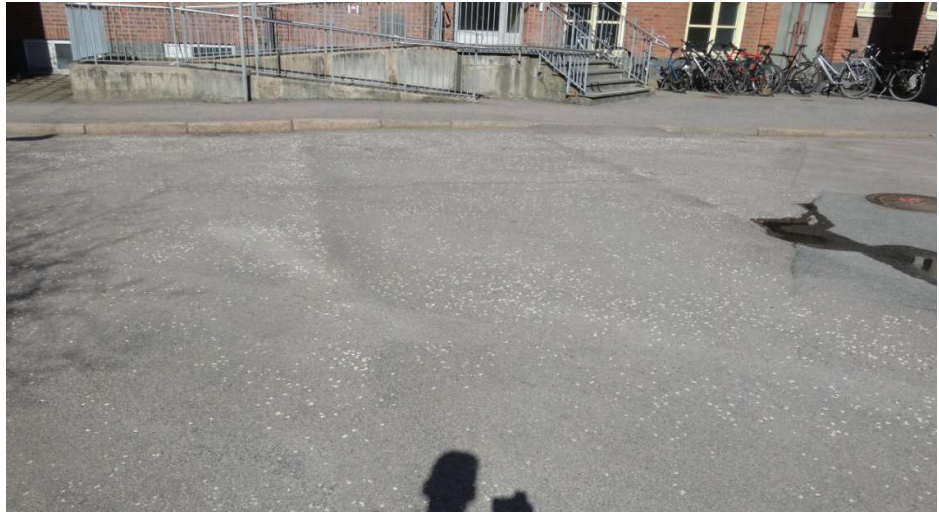
Bild 19 tagen mot norr där mindre sättningsskador har justerats där befintligt kulvertstråk går under mark.
