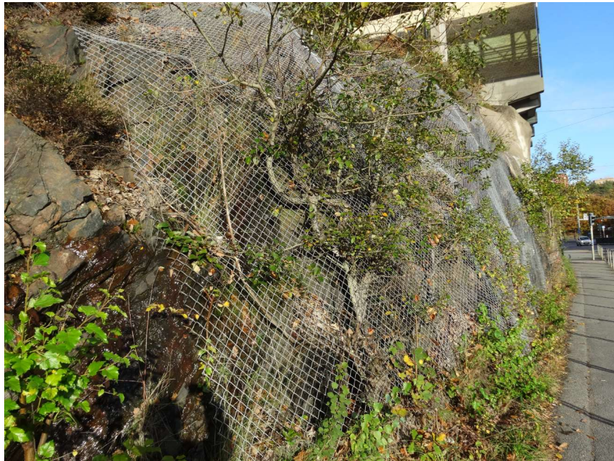
Bild 14 tagen mot öster på bergskärning intill Per Dubbsgatan som förstärkts med nät och sprutbetong längre bort. Inom vissa partier rinner dagvatten ner från berget.
