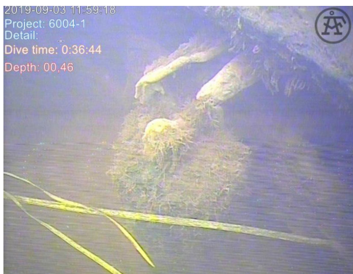
Fotot visar en typskada på en rustbädd (vilket är en del av kanalmurens grundläggning), där bärlina och träpåle har ruttnat och saknar anläggning mot varandra
