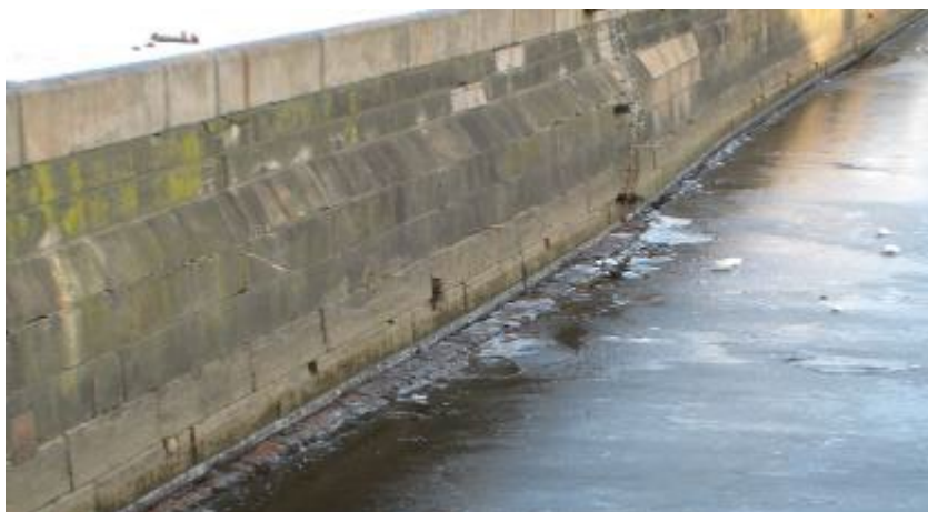
Pågående deformation av kanalmur
