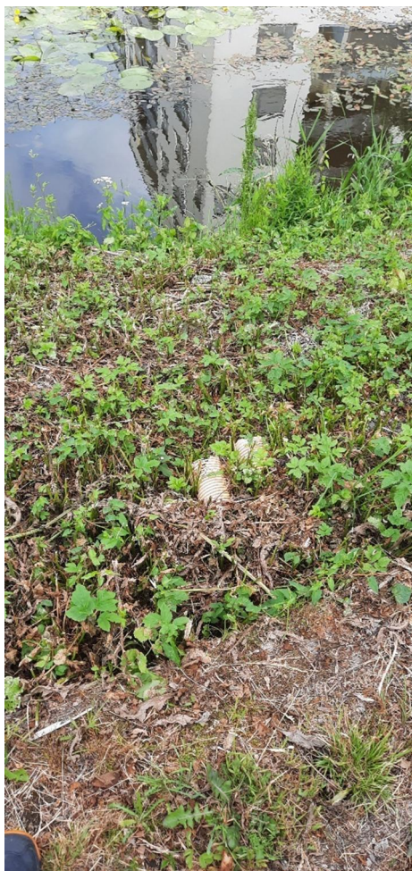
Figur 10 Dräneringsrör i slänten på bäckens östra sida, ungefär i höjd med Borstbindaregatan.
