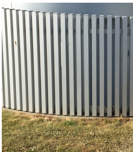
Lättmetallribbor som beklädnad runt ett teknikhus vid domstolarna i Jönköping.
